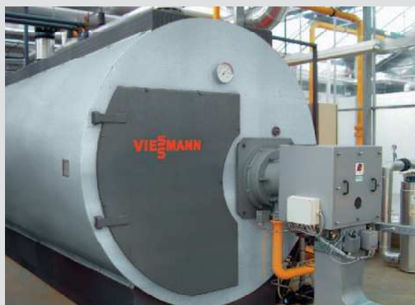
Водогрейный котел Vitomax 200-WS в эксплуатации.
